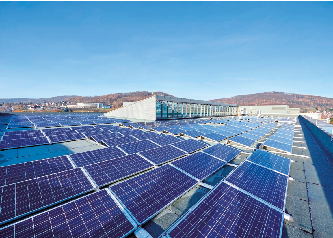
Typische PV-Aufdachanlage im Commercial-Segment
